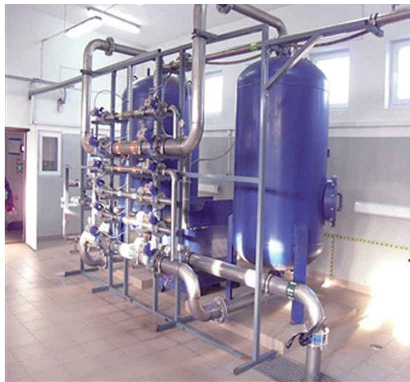
Hydrofornia na SUW Gulczewo.
