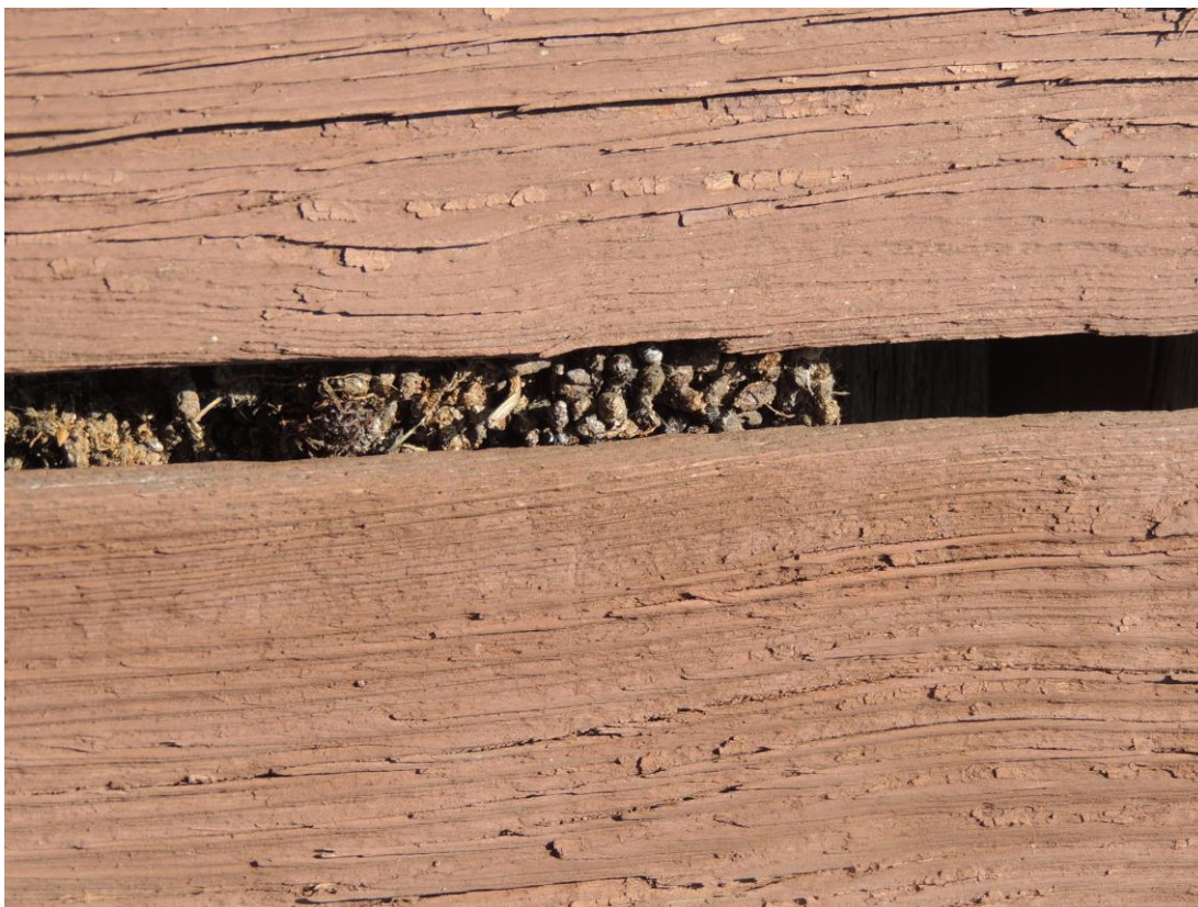
Fot. 56. Kościół św. Marcina w Słupnie, widoczne odchody nietoperzy w szczelinach desek pod stropem. Fot. W. Pawenta.
