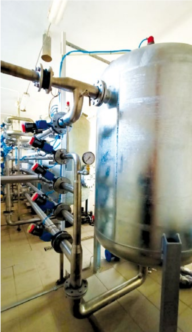
Stacja Uzdadniania Wody w Mijakowie
